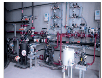
Betankung mit Eintankkontrollsystem Tanking up with single-tank control system
