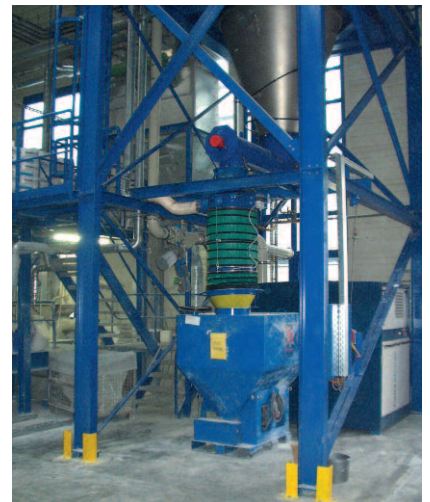
Verwiegen und Abfüllen Weighing and filling
