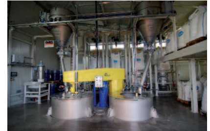
Gesamtanlage Entire line
