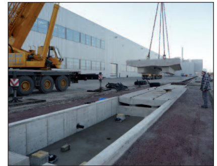
Montage der kombinierten Gleis/Fahrzeugwaage Mounting of the combined rail and street weighbridge
