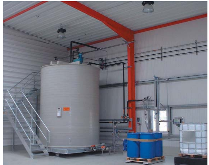
Mischbehälter mit Befüllstation
