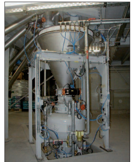
Waage und Drucksender Scales and pressure transmitter
